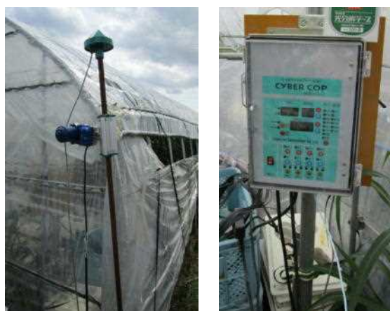
写真2 ハウス側窓の自動換気装置 (撮影:上川農業改良普及センター)
