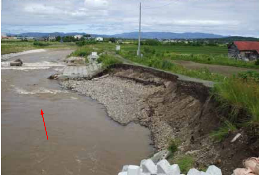
倉沼川御成橋下流決壊状況 (H30. 7. 6撮影)
