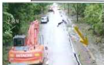
写真-5 ④の被災状況
