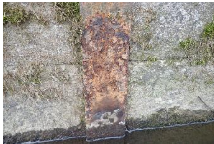
H鋼の腐食
