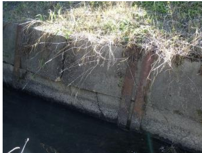
コンクリート板の破損
