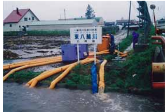
平成10年8月の浸水被害(東八線川)
