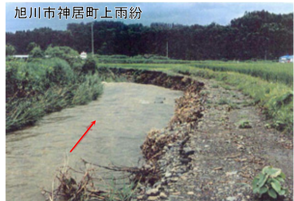
雨紛川 平成11年7月の被害状況
